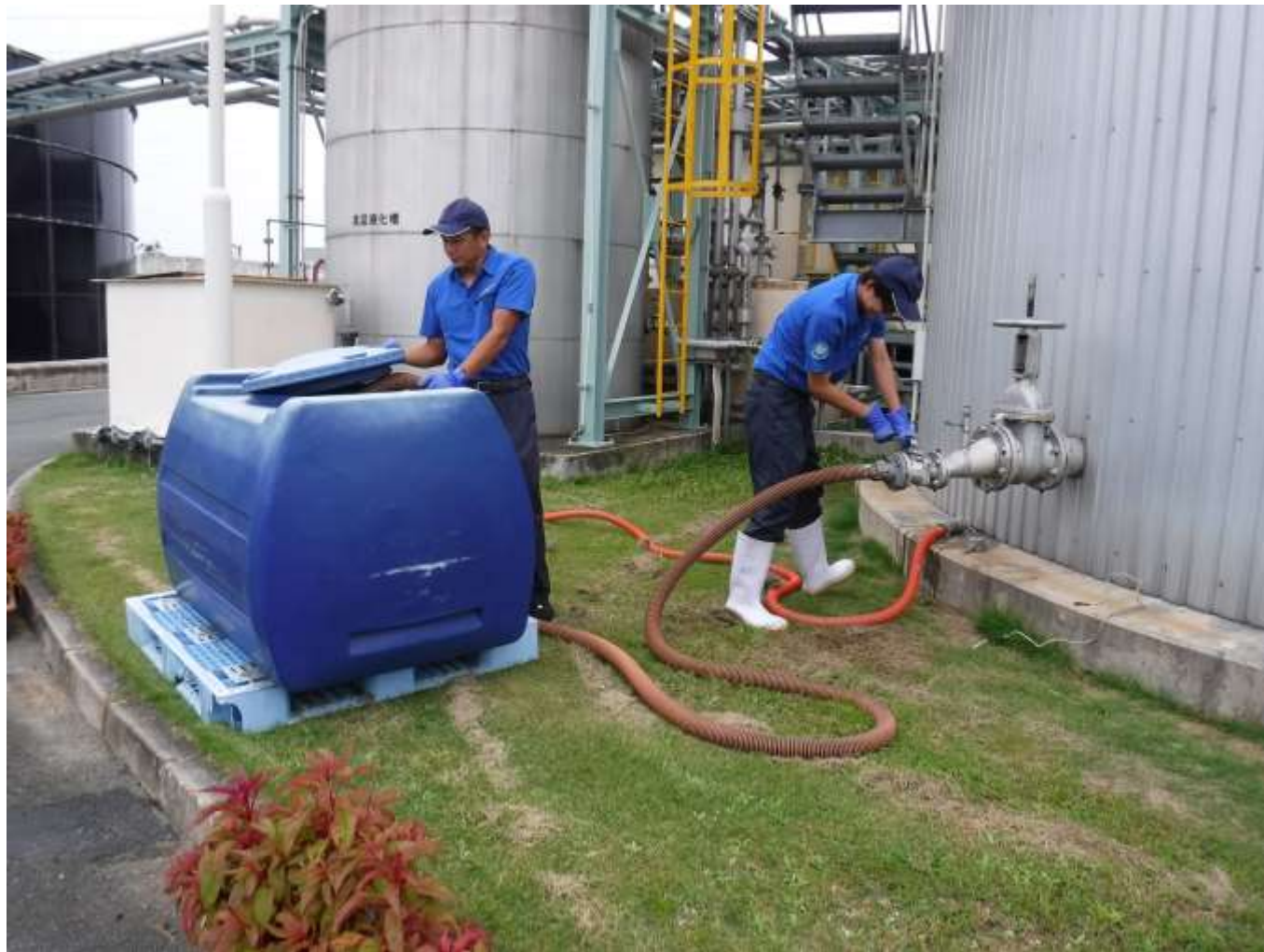
メタン発酵槽底部抜き出し状況 毎週1回実施
